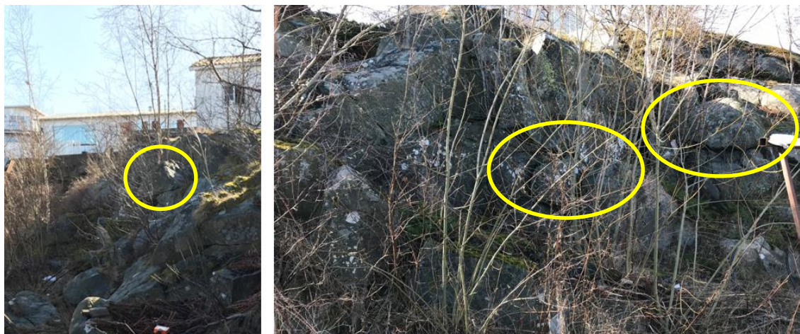
Figur 12. Slänt A, med inringade problemblock till vänster och höger. Närbild på inringat problemområde från Figur 11 synligt till vänster.
