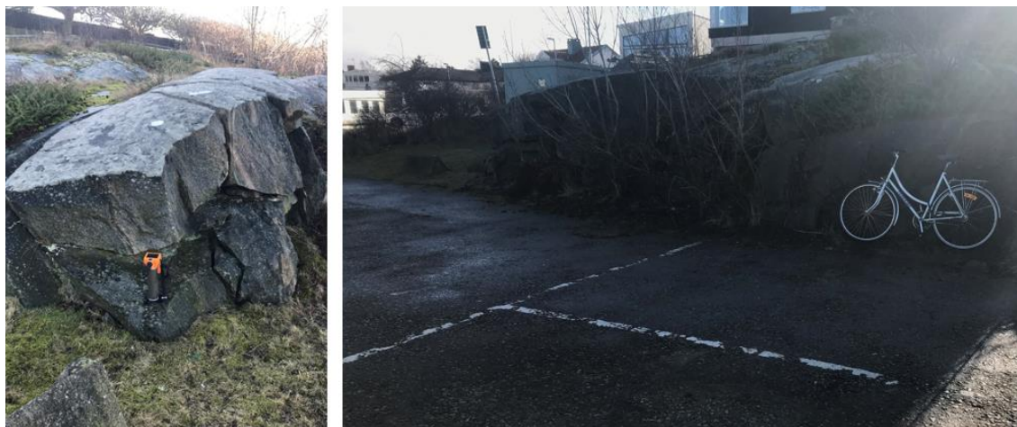
Figur 15. Slänt E; delvis sprängd låg bergskärning. Till vänster syns ett par lösa block på skärningens östra ände. Också synlig i bild till vänster är den orangea gammadetektorn.
